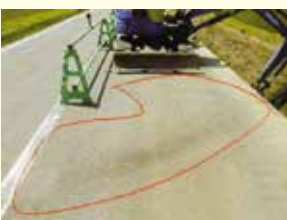
バックホーの作動油のホースが破裂して、舗装の上に漏れている。
