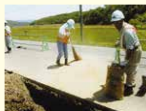
舗装に漏れた作動油に現場で備蓄していたオイルゲーターを撒き、油吸着させている状況。
