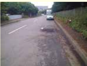
違法駐車車両からの油漏れ。 舗装面にオイルが飛散している状況。
