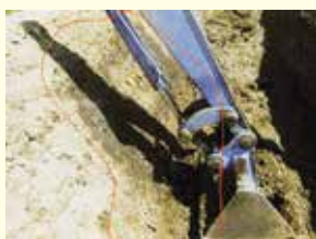
バックホーの作動油のホースが破裂して、内法面上に漏れた状況。
